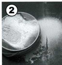
2 次に施工した同じ粉をふるいにかけます。目が細かければ細かい方がいいです。小さいキズの補修であれば、さらにパストのように目の細かいものでふるいます。骨材などが全て取り除かれた微粉末の粉だけを使います。
